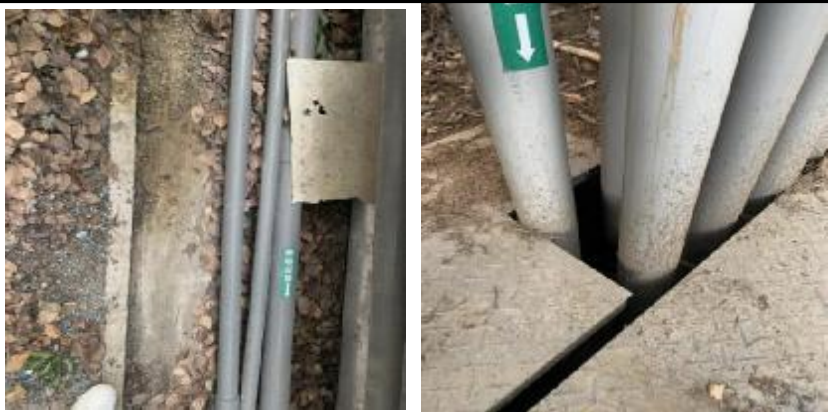
废水处理区管道
